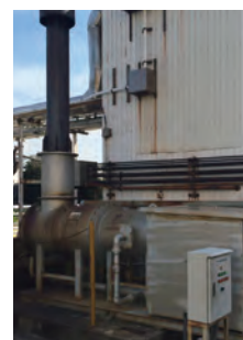
●残ガス燃焼装置
