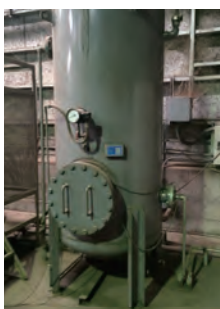
●バッファータンク
