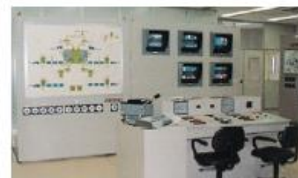
中央監視操作室
